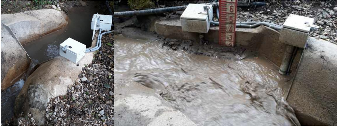
Figura 17: Fotos de la estación de aforos una vez instalado el sensor de turbidez.
