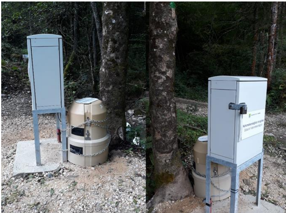
Figura 18: Fotografías del tomamuestras una vez instalado y asegurado al armario donde se encuentra el controlador de las sondas.
