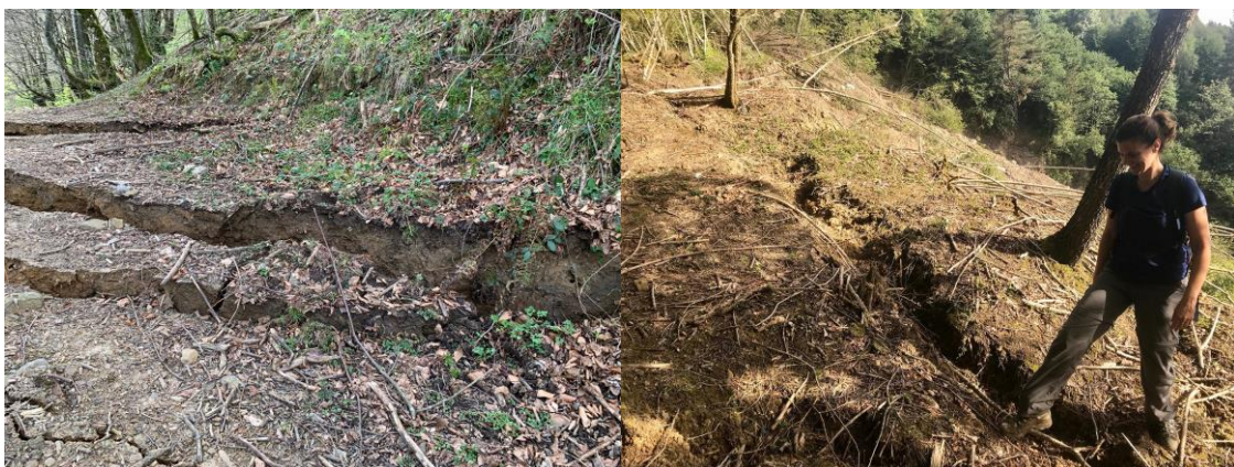
Figura 29: Fotografía tomada a los pocos días de ocurrir el deslizamiento en la parte superior (izquierda), y la zona de grietas tras el escalón de la zona intermedia (derecha).
