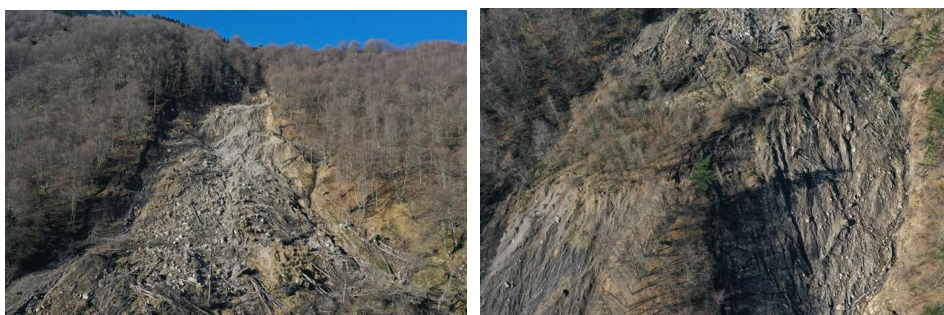
Figura 26: Fotografías aéreas de enero de 2022, mostrando la parte superior del deslizamiento (izquierda) y la zona del escalón central (derecha). Se pueden observar las acanaladuras producidas por la escorrentía superficial, y la regata Gorospe en el margen derecho.
