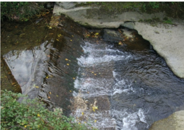
Hondatutako ohantzeko hormigoizko lauzaren aztarnen xehetasuna. Detalle de restos de losa de hormigón de lecho, deteriorada.
