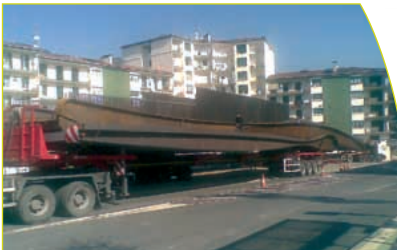
Colocación de una de las pasarelas sobre el río Oria el pasado mes de marzo.
