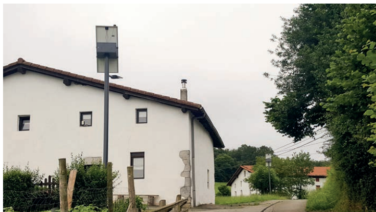
20. IRUDIA. Energia fotovoltaikoko argiteriaren instalazioa auzo batean.
