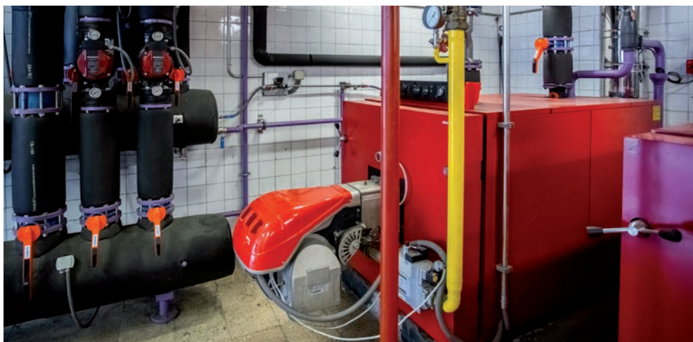
13. IRUDIA. Egogain zentro gerontologikoan instalatutako kondentsazio galdarak.
