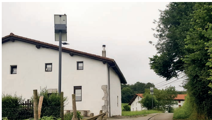
IMAGEN 20. Instalación de alumbrado por energía fotovoltaica en un barrio.
