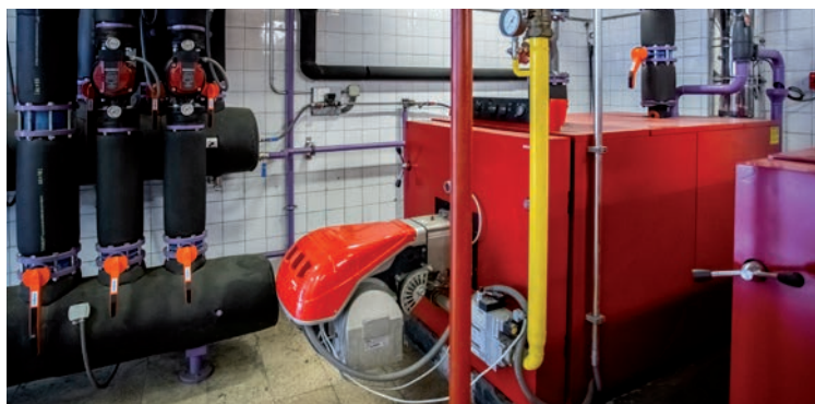
IMAGEN 13. Calderas de condensación en el centro gerontológico de Egogain.
