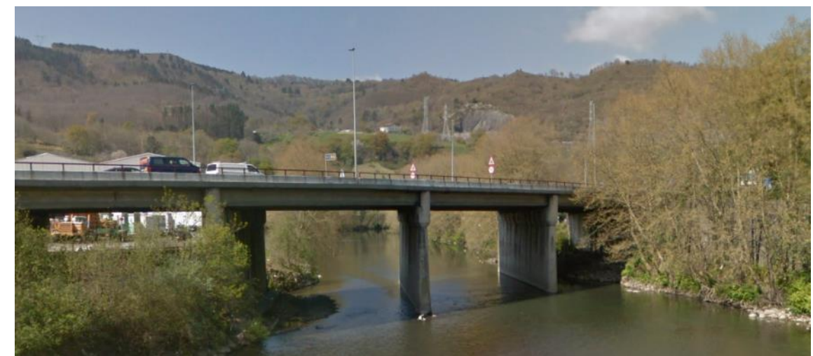
Imagen 86. Aspecto del puente existente sobre el río Oria que sería objeto de ampliación
