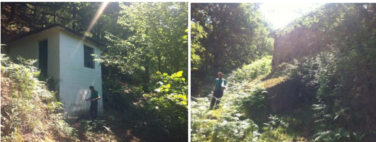
Fotos 1 y 2: Casetas 7 y 8.
