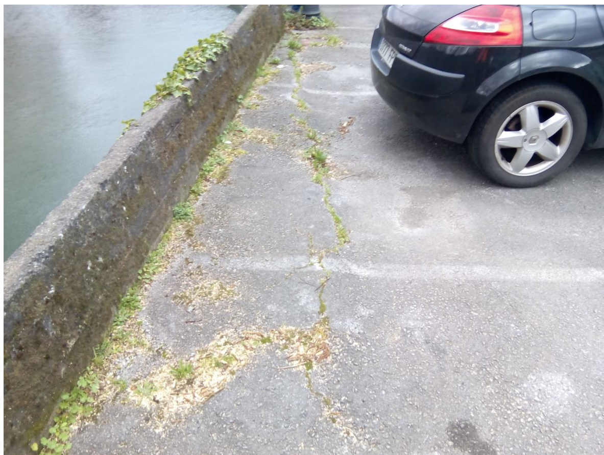
Desplome del pretil y fisuras en el aglomerado asfáltico del aparcamiento
