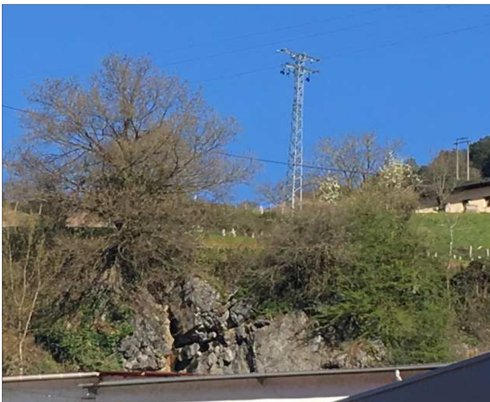
Fotografía nº5.- Torre eléctrica en cuyo pie se sitúa el CT de la empresa Langa Poes, S.L.
